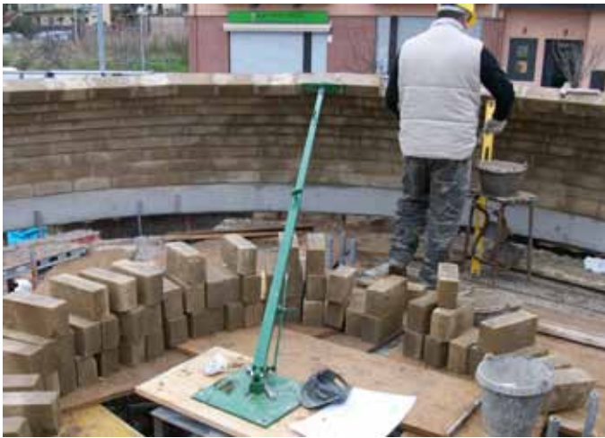
SISTEMA AMB ELEMENT TELESCÒPIC PER A L'EXECUCIÓ DE CÚPULA NÚVIA AMB BLOC DE TERRA COMPRIMIT A L'ESCOLA BRESSOL DE SANTA EULÀLIA DE RONÇANA
