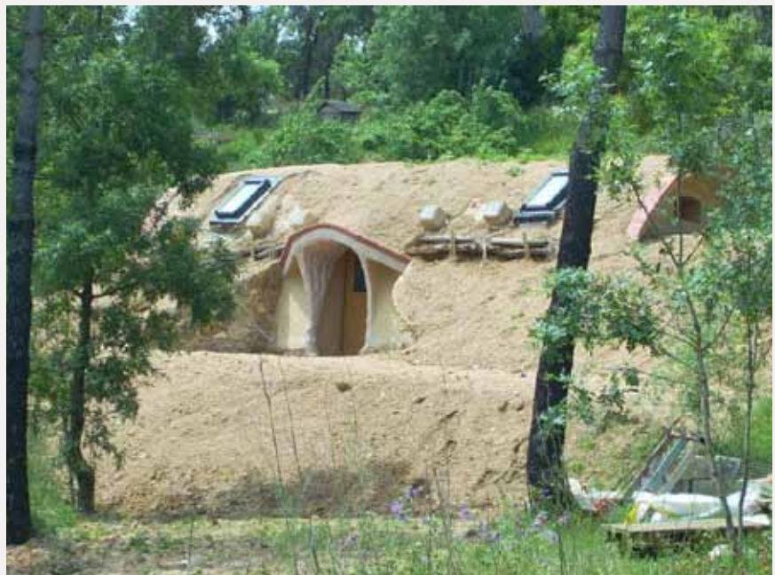
BANYS SEMISOTERRATS AMB VOLTA DE CANÓ, ESTRUCTURA DE BAMBÚ I PROJECTADA AMB TERRA, FIBRES VEGETALS I CALÇ, ACABAT EN JARDINAT
